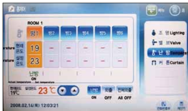
Comfortabele bediening van KNX-functies via een centraal touch panel: bijvoorbeeld, menu's voor verwarming, gordijnen en verlichting.
